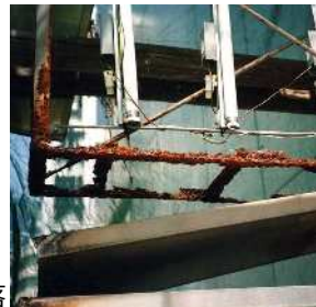
袖看板の底部脱落
