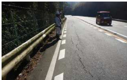
路面の沈下に伴う舗装ひび割れ
