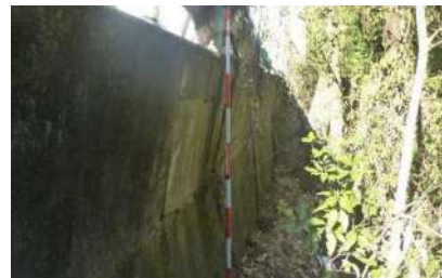
既存擁壁の倒れ
