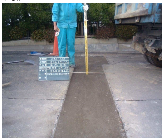
⑪ 路盤工 埋戻工同様、転圧の施工中、施工後の状況を各層毎に撮影し、スタッフ等で深さが分かるように撮影する。
