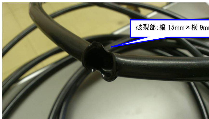
図2 破裂した低圧ホースの様子
