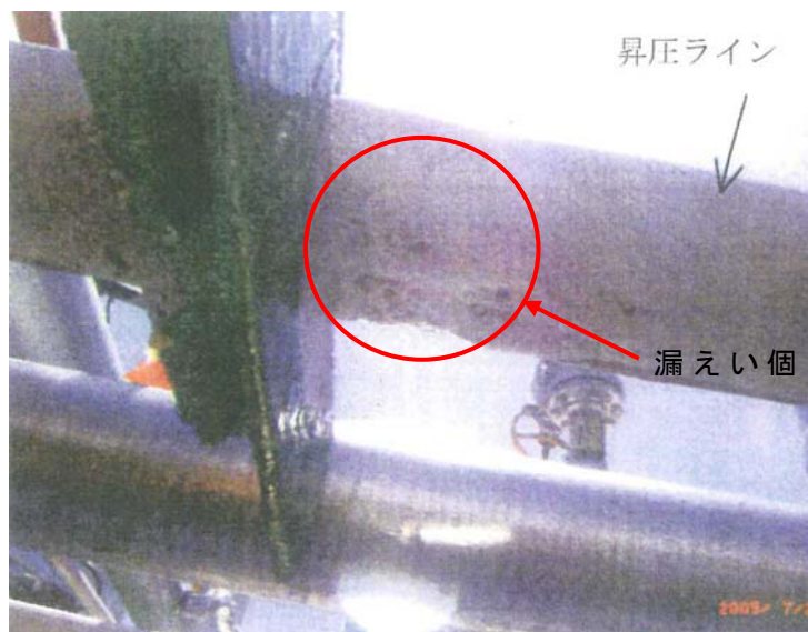
図1 発災箇所状況(断熱材を外した様子)
