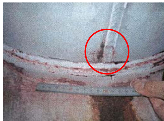
図2 漏えい箇所の写真
