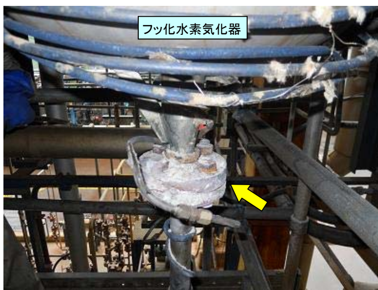
図2 気化器下部ノズルのフランジ締結部の写真
