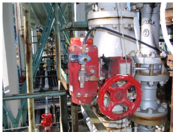
緊急遮断弁の設置状況
