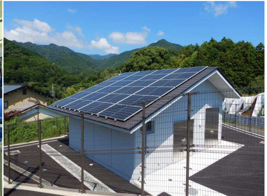
太陽光発電設備の導入 (七沢加圧ポンプ所)
