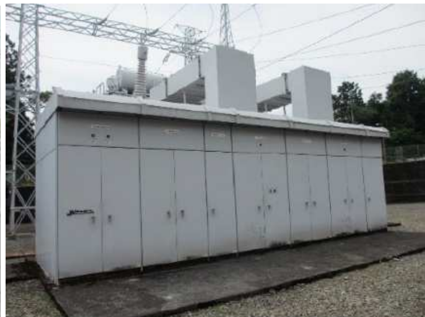
屋外キュービクル
