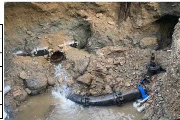
漏水箇所写真
