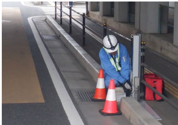
冠水感知器の点検状況
