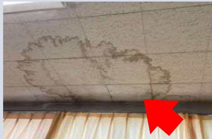
天井からの雨漏り
