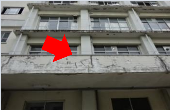
ひび割れだらけの外壁
