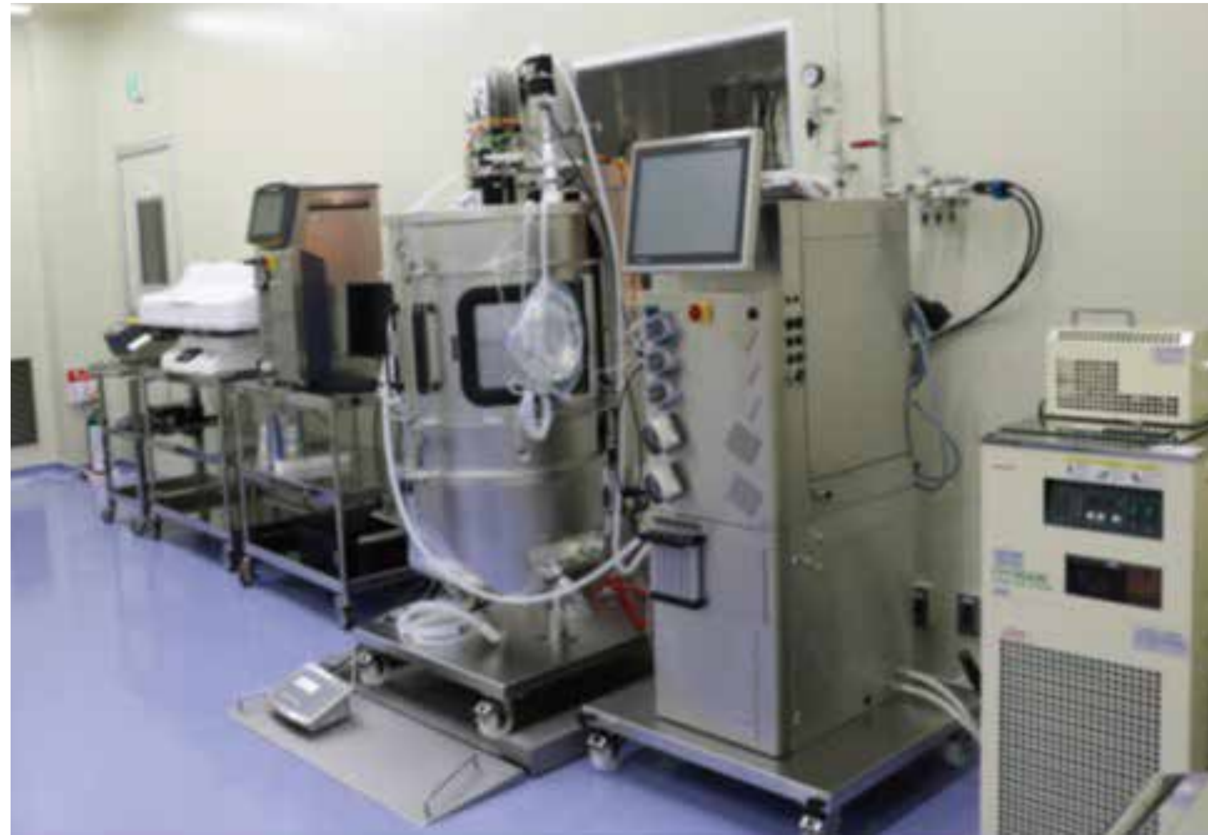
AGJ- 製造施設
