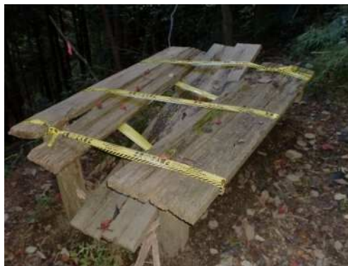
(使用禁止の休憩施設)
