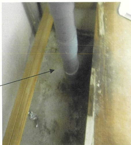
写真6 排水管の底部
