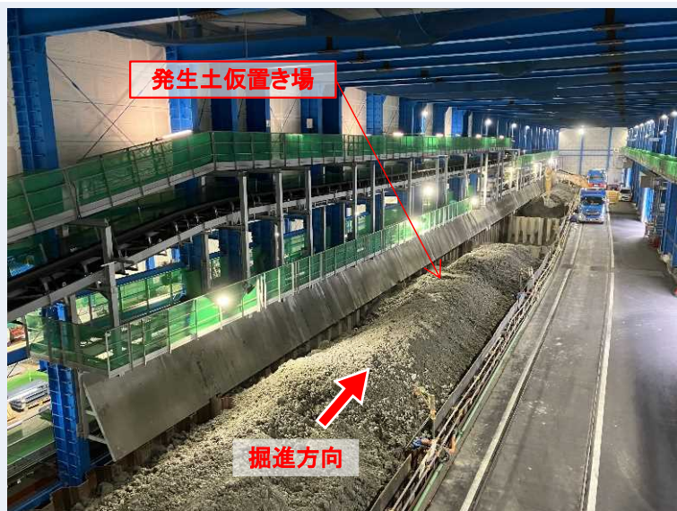
防音ハウス内部(発生土仮置き場)
