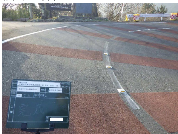
設置状況写真
