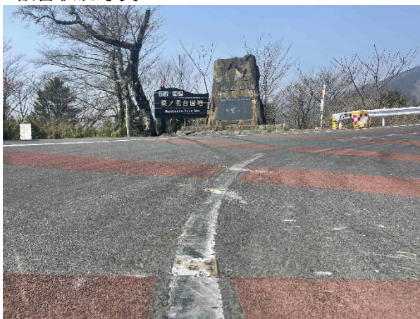
被害状況写真
