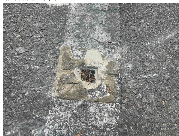
被害詳細写真
