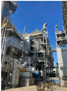
木質バイオマス発電所 （横須賀市）
