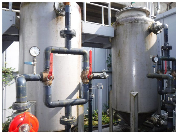
地下水汚染対策（秦野市 浄化施設）
