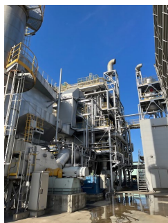
木質バイオマス発電所 （横須賀市）
