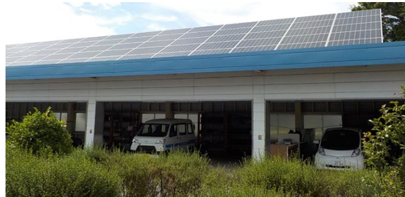
太陽光発電設備（相模原水道営業所）
