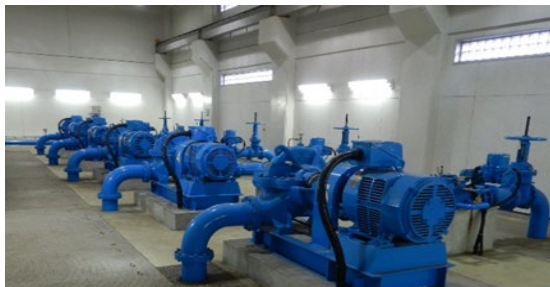
ポンプ設備（及川ポンプ所）
