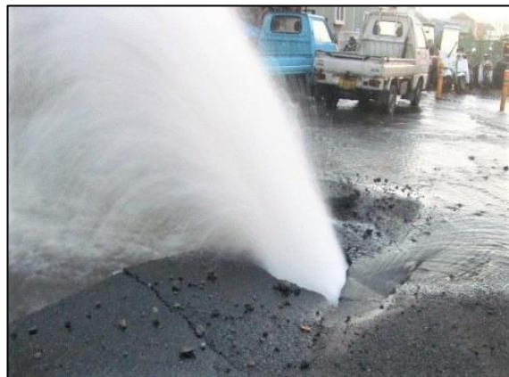
図—4 漏水事故の発生状況
