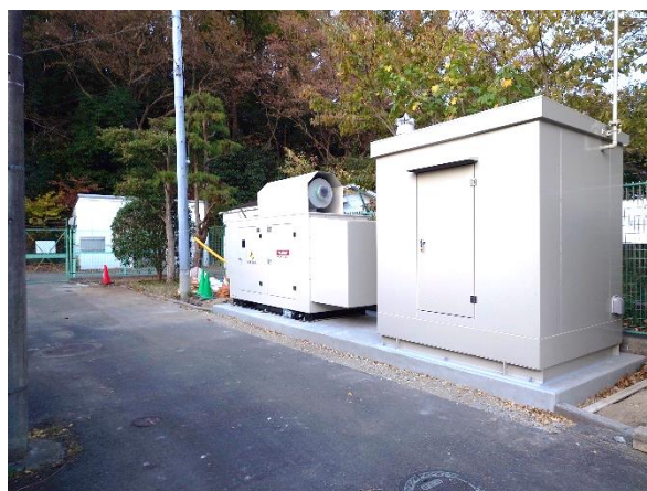
【図 15】 非常用発電設備
