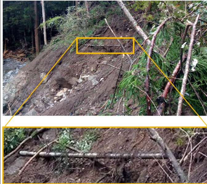
【図19】令和元年台風第19号の被害
