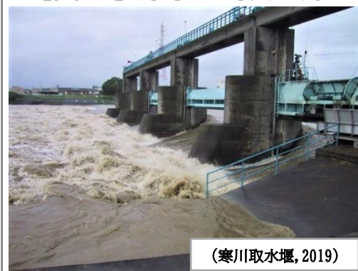
【図23】原水の濁度上昇
