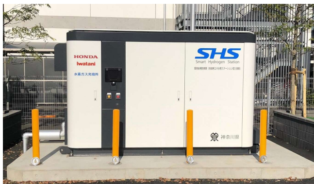
（県再エネ水素ステーション外観）
