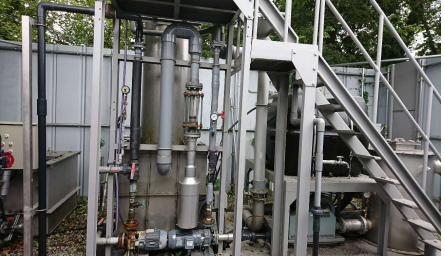
地下水浄化設備 (秦野市)
