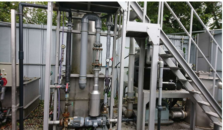
地下水浄化設備(秦野市)
