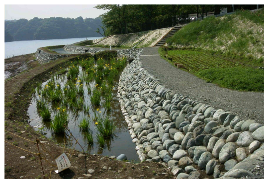
(三井地区植物浄化施設)
