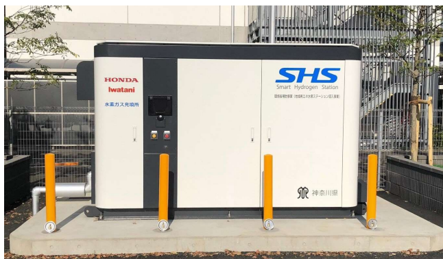
（県再エネ水素ステーション外観）
