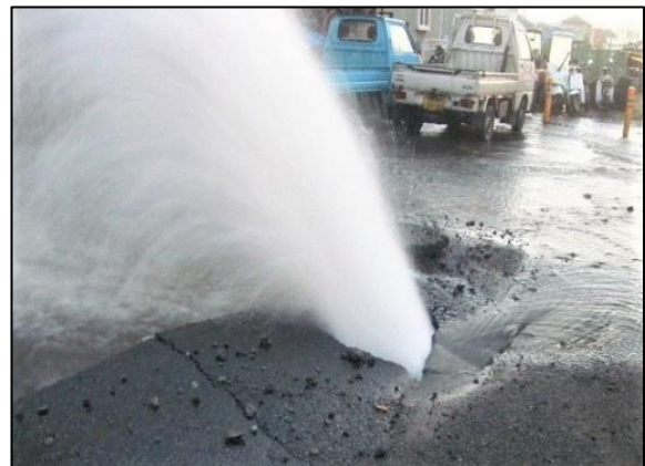
図—4 漏水事故の発生状況
