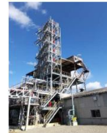
ケミカルリサイクル実証設備
