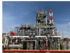
環境に配慮したエチレン由来のエチレン試験製造設備（千葉県原市）
