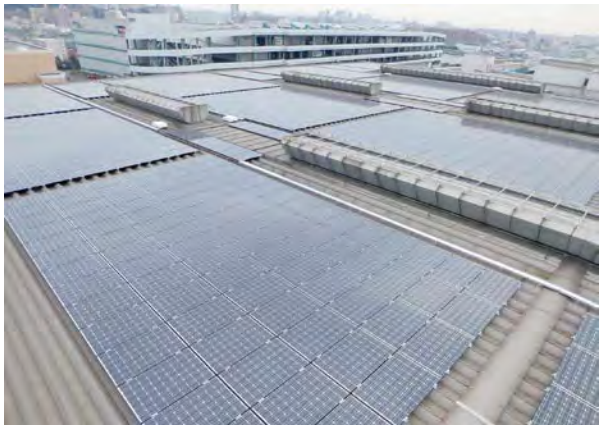
(AGCロジスティクス(株)京浜生麦センター)
