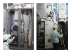
ビル設備管理 設備点検の仕方
