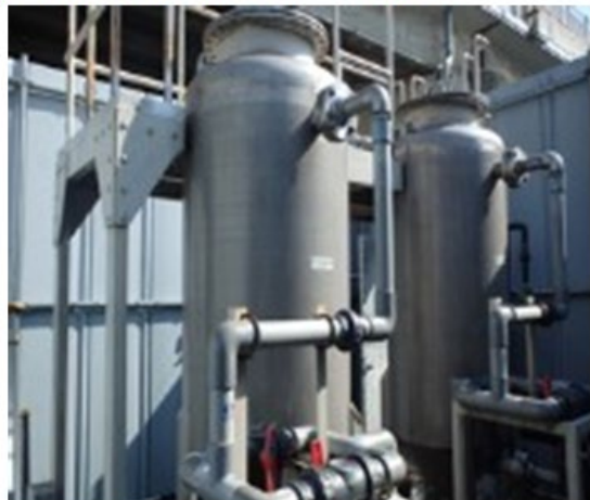
地下水汚染対策（秦野市 浄化施設）
