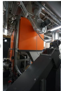
燃料搬送装置 (上部)
