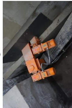
燃料搬送装置 (下部)
