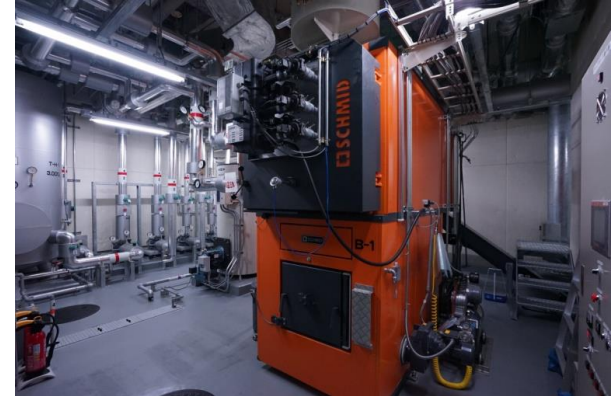
木質チップボイラーと ボイラー室内部
