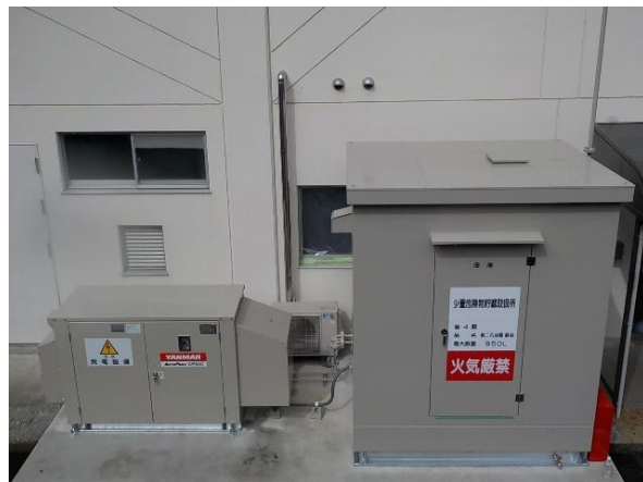
【図 15】 非常用発電機
