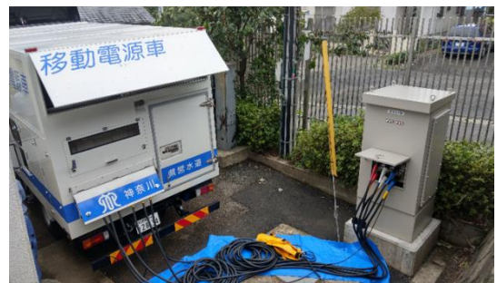
【移動電源車に対応した設備】
