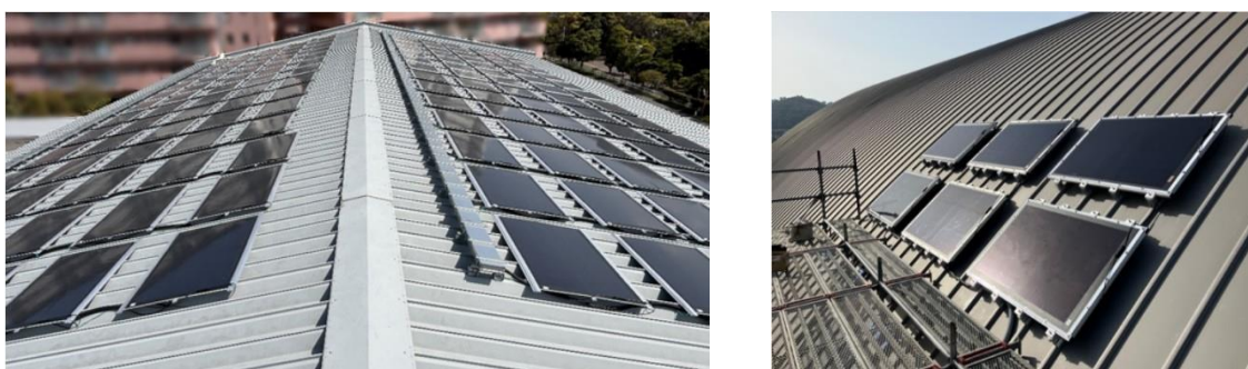
図表 16 実証の様子（小学校体育館の屋根）
