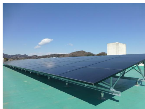
県立愛川高校に設置した太陽光パネル
