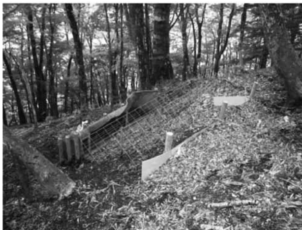
写真6 リター捕捉金網工
