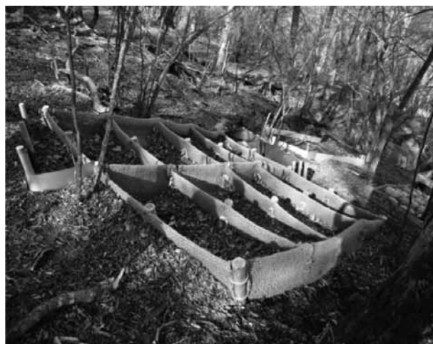
写真1 リター捕捉ネット工
