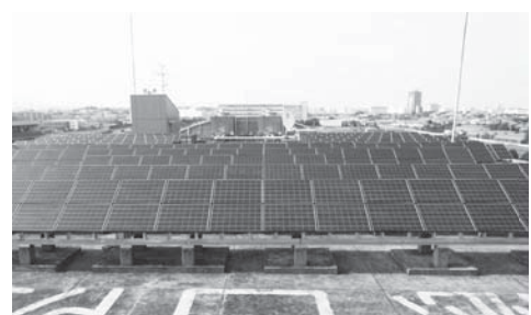
総合防災センターに設置した太陽光発電設備
