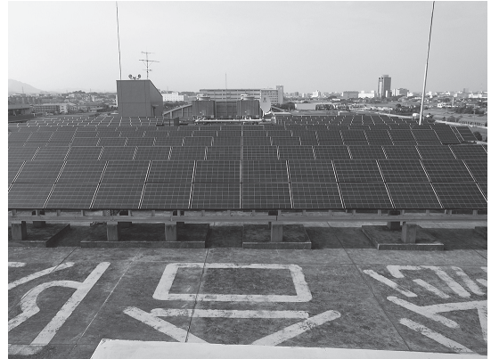
総合防災センターに設置した太陽光発電設備
