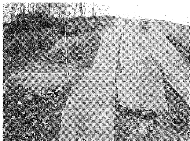
写真12 落下角礫岩による伏工損傷
