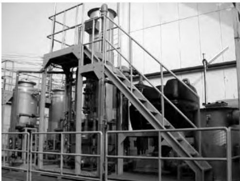
地下水浄化設備（秦野市）
