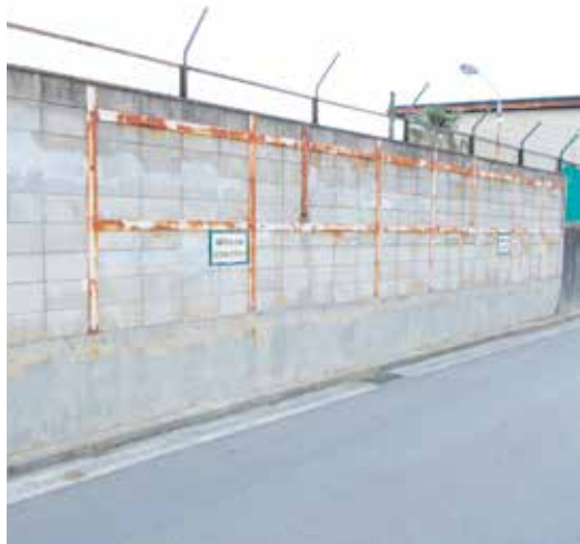
老朽化したコンクリートブロック塀
