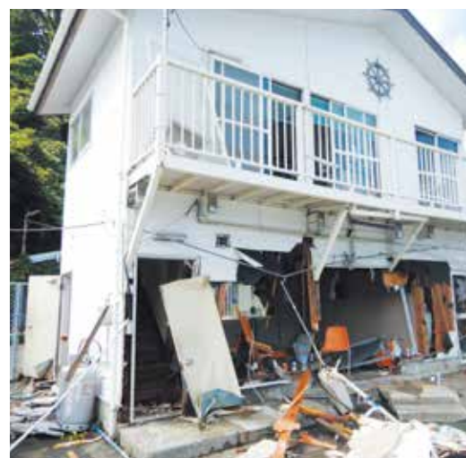
高波で破損した真鶴港管理事務所
