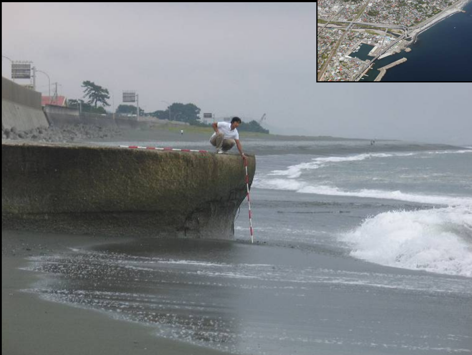
写真-10 山王川河口の右岸導流堤先端部に形成されたノッチ
