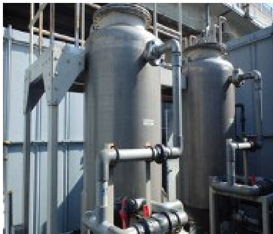
地下水汚染対策（秦野市 浄化施設）
