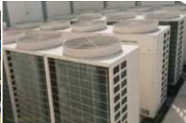
空調設備（藤沢水道営業所）
