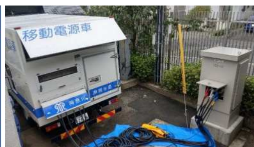
移動電源車に対応した設備
