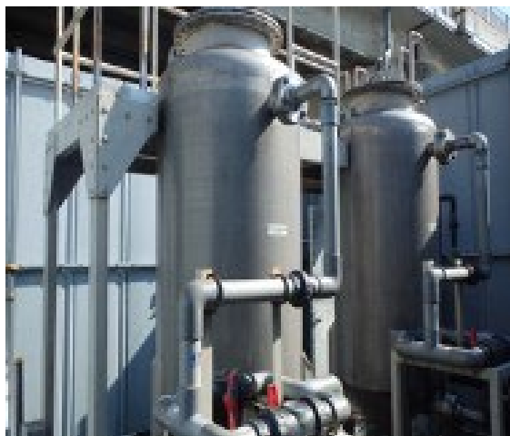
地下水汚染対策（秦野市 浄化施設）
