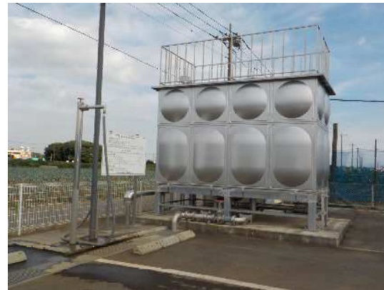
改修後ポンプ施設（給水スタンド）
