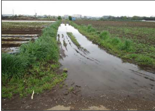
未舗装農道の排水不良の状況（降雨から1日後の状況）
