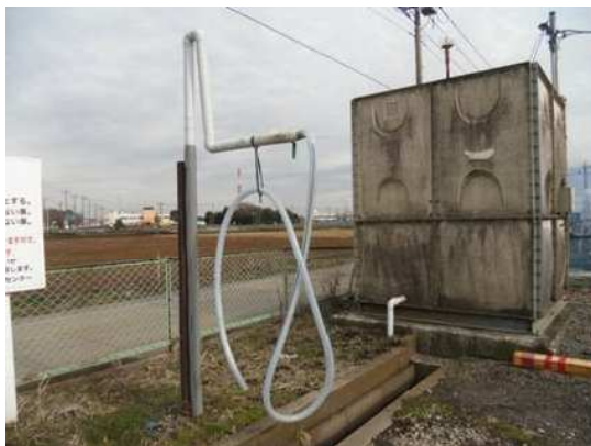
既設ポンプ施設（給水スタンド） ポンプ施設及び揚水管の老朽化の状況
