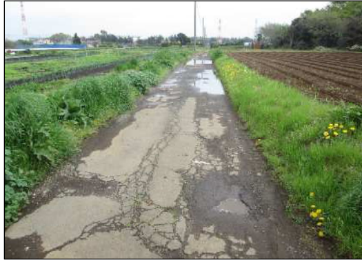
舗装農道の破損及び排水不良の状況
