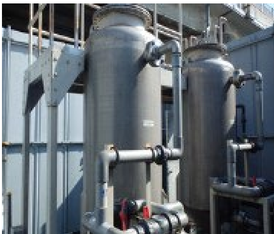
地下水汚染対策（秦野市 浄化施設）
