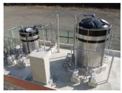
凝集剤添加設備
