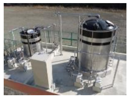
凝集剤添加設備
