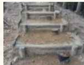
園路内の段差
