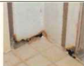
施設の老朽化（トイレ）
